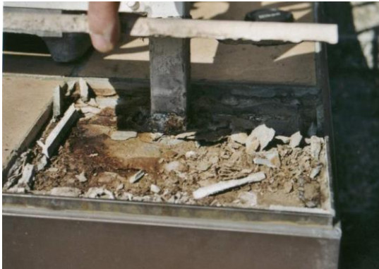
Nevhodně řešený detail ukotvení
